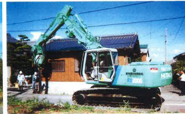
PALSONIC-10D 三重県川越町役場下水道課/下水面整備工事 軽量鋼矢板Ⅲ型-3m ベースマシン:RX2000 土質:砂 N値:4
