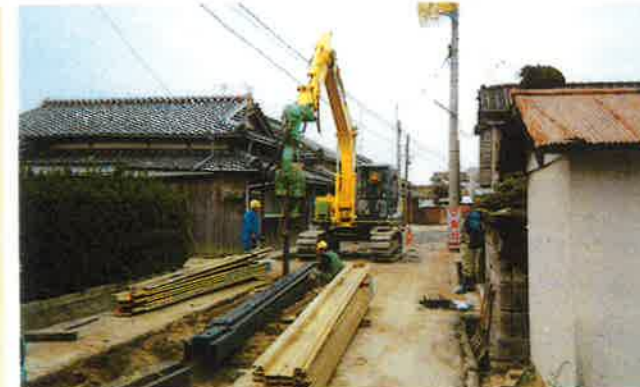
PALSONIC-4B 山口県防府市役所下水道課/公共下水道築造工事 軽量鋼矢板Ⅲ型-4m ベースマシン:0.35㎡ 土質:シルト N値:5
